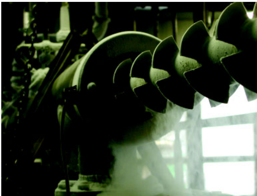
Geöffnete Kryoschnecke der Kaltmahlanlage
