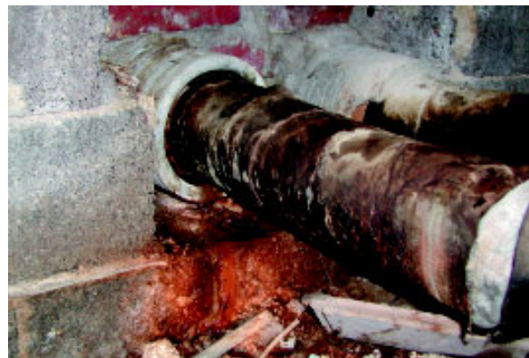
Korrodierte Rohrleitung mit Leckage
