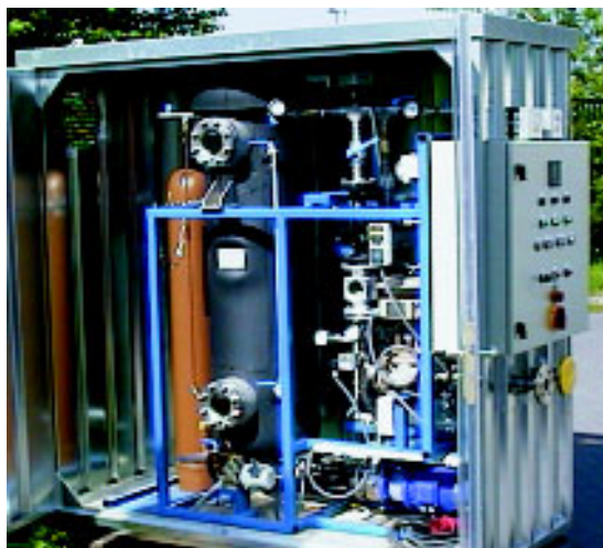
Anlage zur Heliumbeladung von Fernwärmewasser in Containerbauweise
