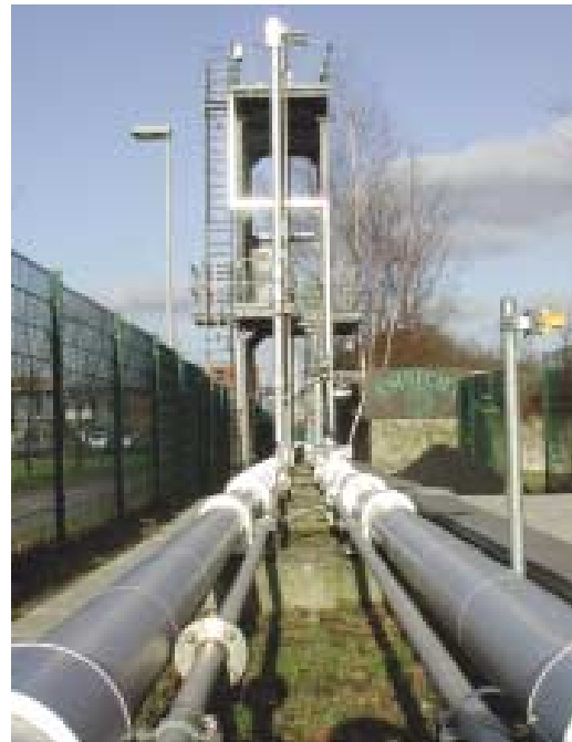
Rohrleitungsversuchsfeld bei Fraunhofer UMSICHT (unten: Ausschnitt)
