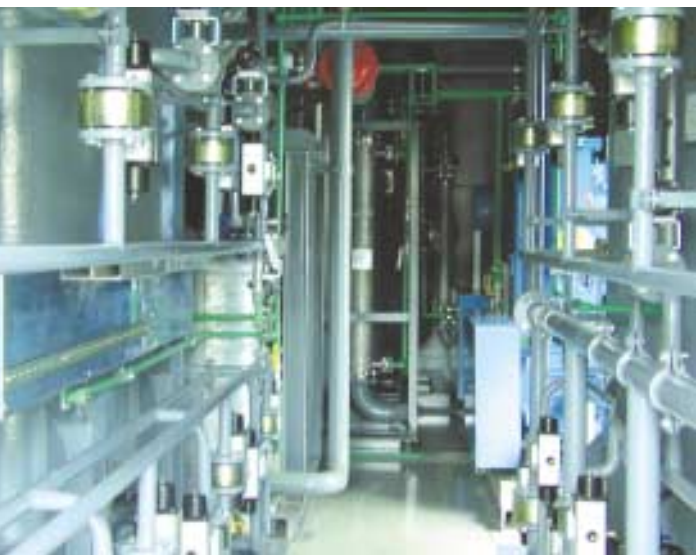
Mit der zweistraßigen Druckwechseladsorptionsanlage schmeckt der PEM-Brennstoffzelle sogar Gruben- und Biogas
