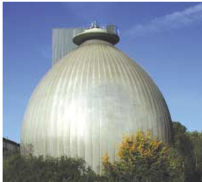
Der Faultrum glänzt als imposantes Kernstück einer Kläranlage in der Sonne
